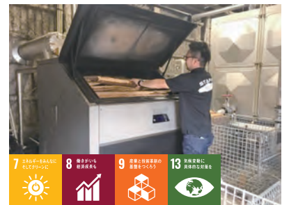
図表9 木質バイオマスボイラー
